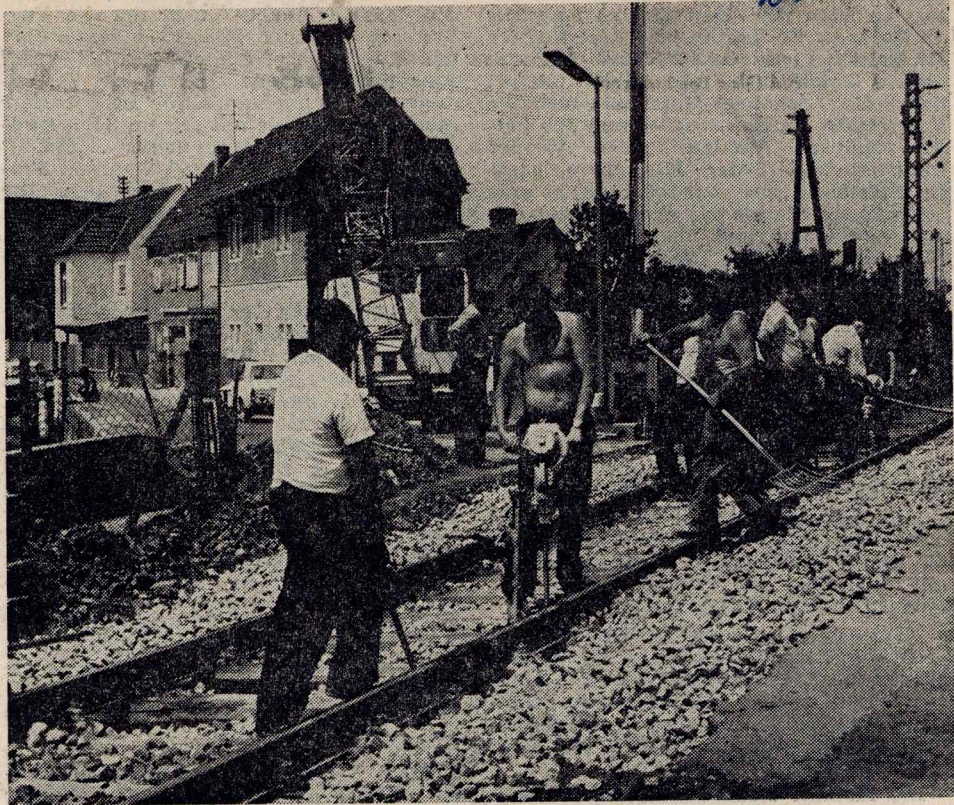
DER BAHNÜBERGANG Mahlweg in Nackenheim und der Übergang in der Gartenfeldstraße bleiben wegen Gleisarbeiten in diesen Tagen für den Kraftfahrzeugverkehr gesperrt. Zum Passieren der Fußgänger sind Bohlen ausgelegt worden. Foto: Klos
